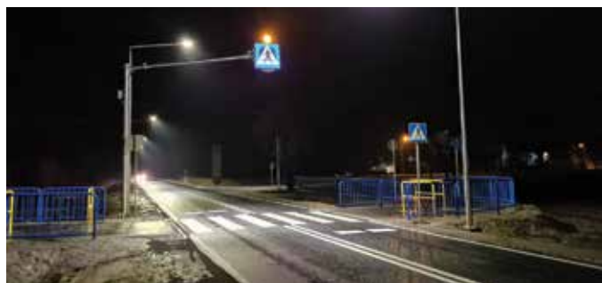
Oświetlenie przejścia dla pieszych
