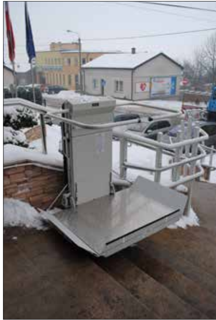
Platforma ułatwiająca osobom niepełnosprawnym dostanie się do budynku starostwa
